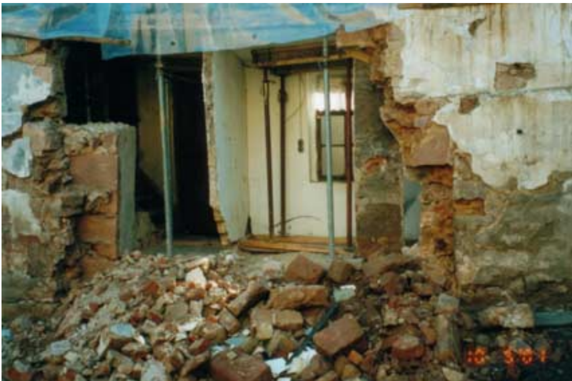
Tagesbruch in Rochlitz (Foto: Bergsicherung Sachsen GmbH)
